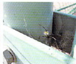
フェンスの支柱のすき間
